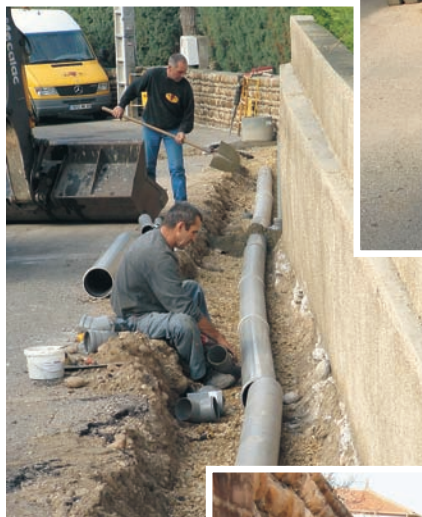
"récupération des eaux pluviales"
